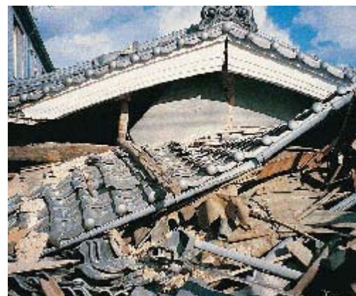
ТРАДИЦИОННЫЕ ЧЕРЕПИЧНЫЕ КРЫШИ (БЕТОН, ГЛИНА) ТЯЖЕЛЫЕ В ВЕСЕ И НЕИЗБЕЖНО ВЫЗЫВАЮТ СТРУКТУРНЫЕ ПОВРЕЖДЕНИЯ ВО ВРЕМЯ ЗЕМЛЕТРЯСЕНИЙ
